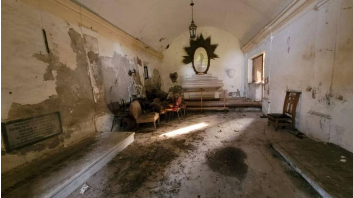
Interior de la capilla del pazo, que sufre actos de vandalismo y en donde hay sepulturas. | FdV
